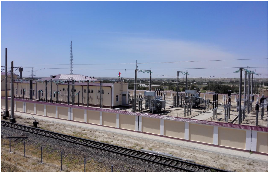
中铁电气化局集团有限公司-乌兹别克斯坦马拉康德-卡尔希铁路电气化项目 110 千伏阿依雷塔姆牵引变电所 110 кВ ТПС Айрытам по проекту электрификации железнодорожного участка Мароканд-Карши в Узбекистане
