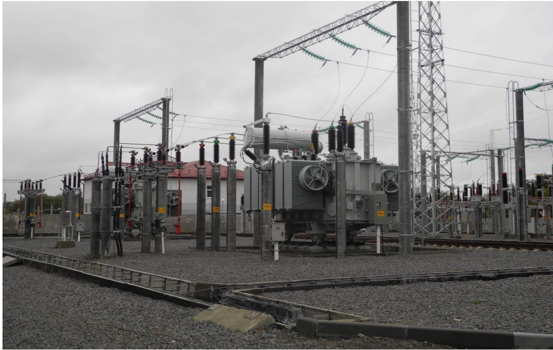
中铁电气化局集团有限公司-白俄罗斯 110 千伏日罗宾牵引变电所 110 кВ ТПС Жлобин в Беларуси
